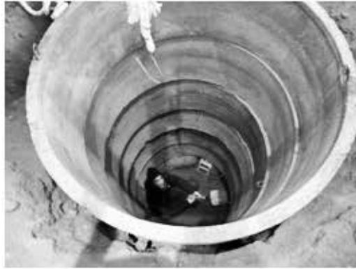
Fig. 7. Muestreo manual a 6m de profundidad utilizando un sistema de dovelas para el entibado.
