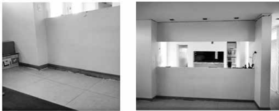
Fig.4. Deformación en piso de porcelanato (cada unidad de 1mx1m) y asentamiento en la pared apoyada en él.
