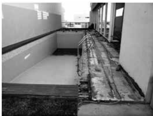
Fig.8. Levantamiento del deck en la zona de pileta para detectar fisuras, fugas o posibles roturas.
