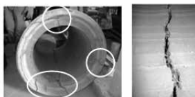
Figura 10. Distribución de fisuras en los laterales y fibras cortadas en THRFA30.
