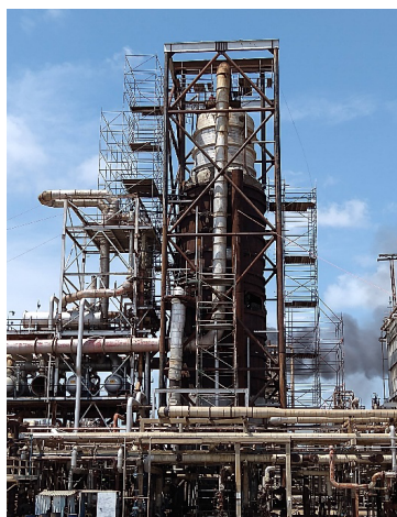
Figura 4. Torre de Destilación al Vacío (PVAY-4), CRP. Fuente: PDVSA PETRÓLEO, S.A, (2022).
